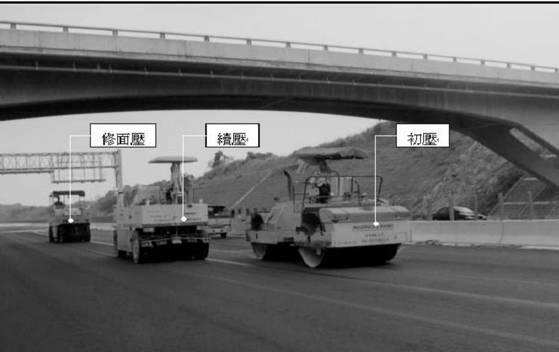
照片 8.3 一部靜重二軸二輪壓路機進行初壓，二部膠輪壓路機進行續壓及修面壓。
