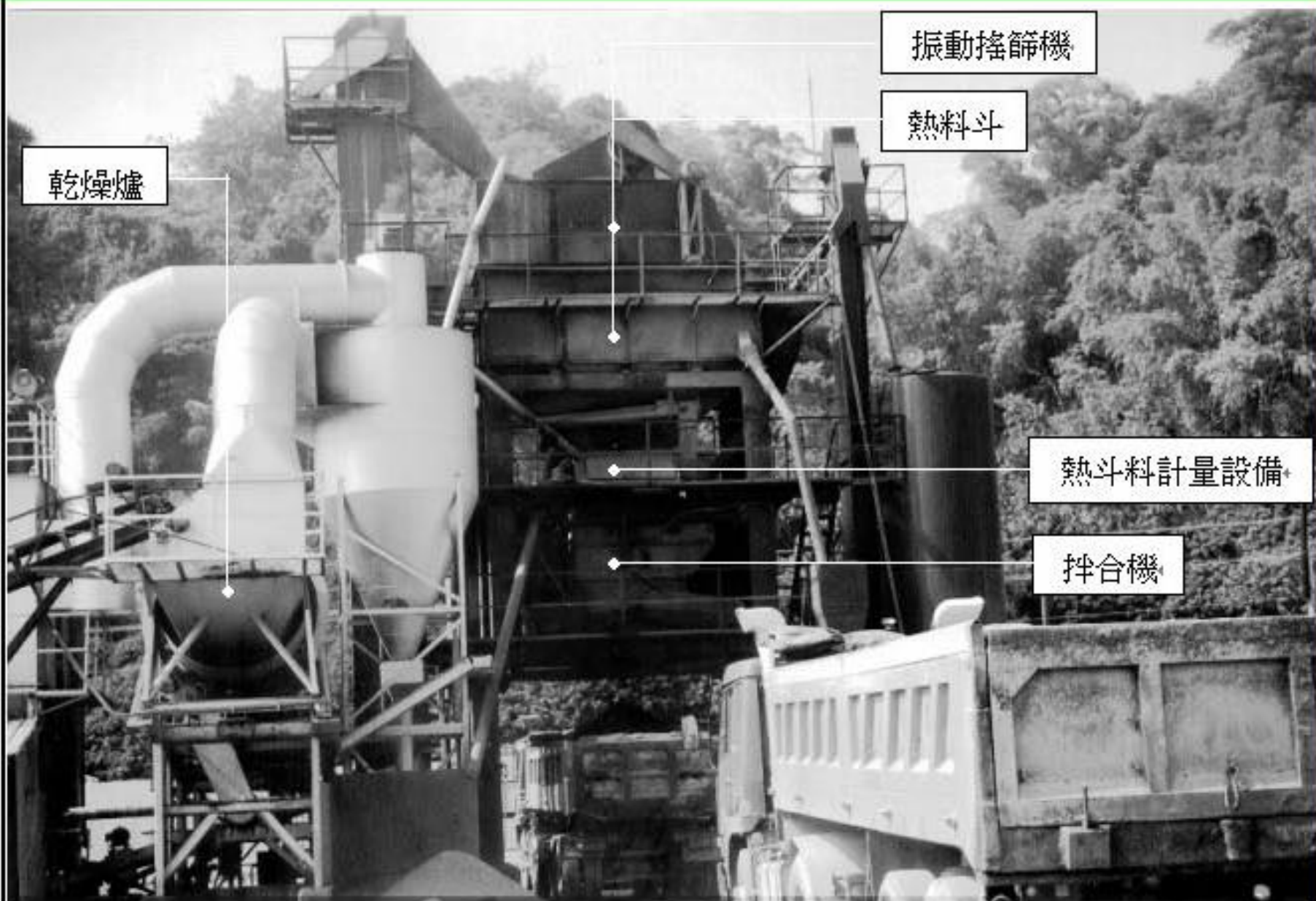
照片 3.5 震動搖篩機、熱料斗、熱料計量設備及拌合機
