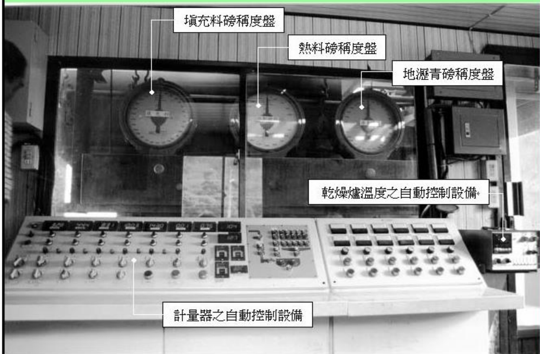
照片 3.13 拌合廠控制室-計量器及溫度之自動控制設備, 131
