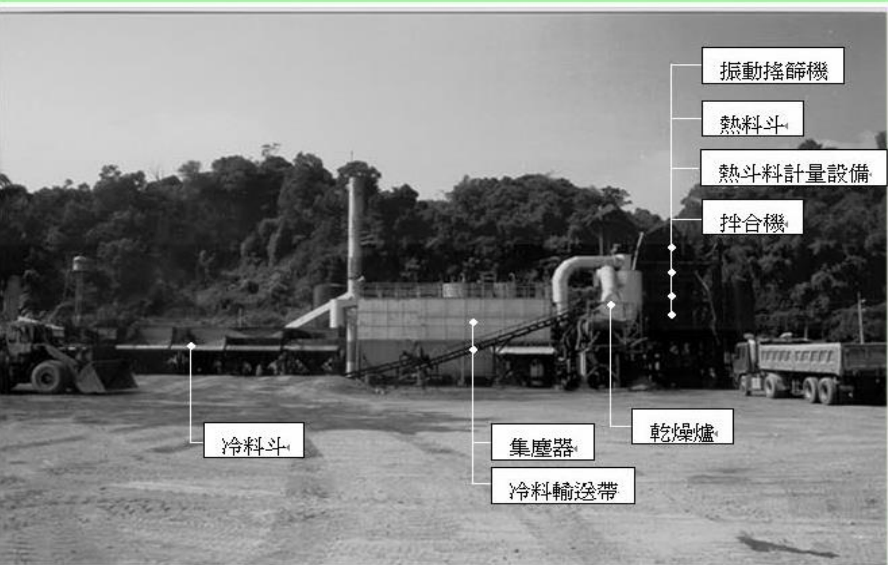
照片 3.1 拌合廠設備(A)
