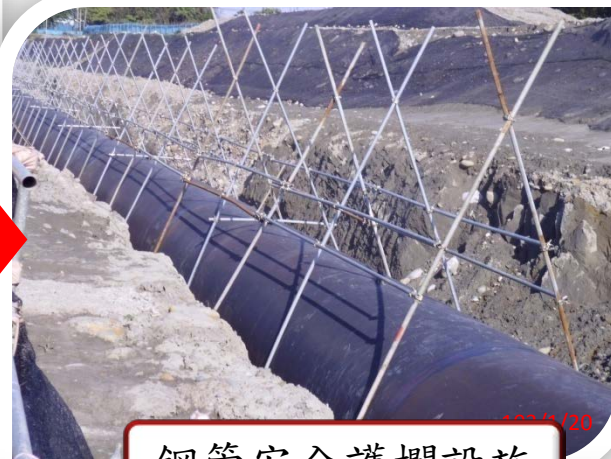
鋼管安全護欄設施
