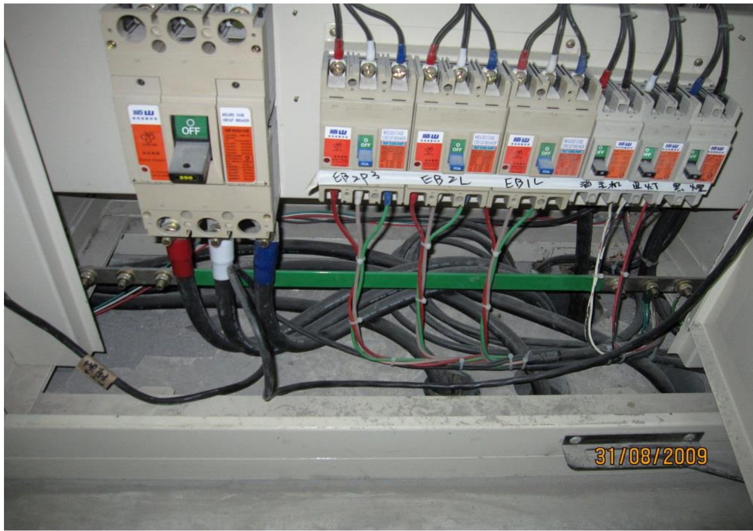
圖103工程會扣點編號5070419 說明：電纜線使用目地未標示
