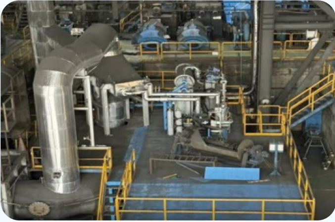
▲ 圖 6、華新麗華廠房加熱爐導入廢熱回收發電系統
