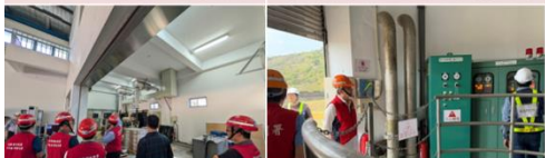
集集緊急發電機測試
