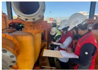
抽檢移動式抽水機
