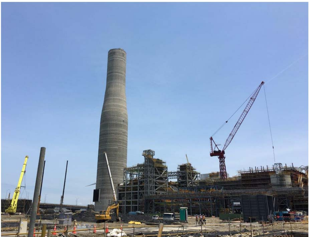
■ 本部施工查核小組 104 年 6 月 15 日查核「林口電廠更新擴建計畫」主發電設備採購案
