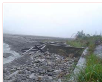
丁壩壩頭 下沉傾斜
