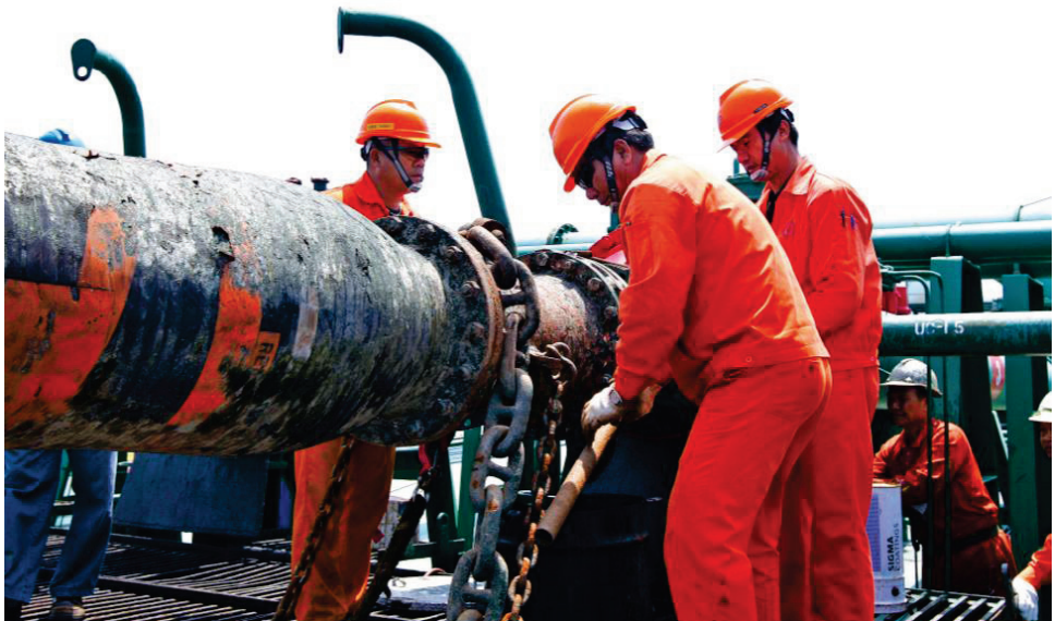
■ 中油公司-外海操作人員將浮蛇管與油輪管路相接之作業情形
