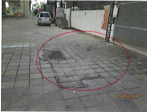
地磚因附近工地重型車輛造成損壞(10500000528)
