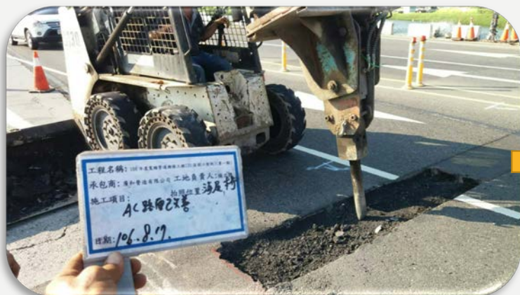
改善中：寬頻管線下陷
