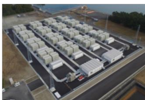
九州電力公司福岡縣發電廠，鈉硫電池總容量為50MW/300MWh
