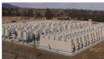
東北電力公司福島縣變電站，鈦酸鋰電池總容量為40MW/40MWh
