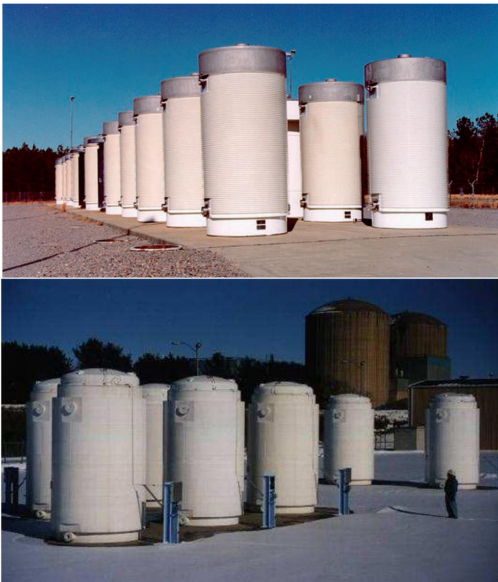
圖 3.1.1-1 美國 Surry 電廠金屬護箱露天貯存設施
