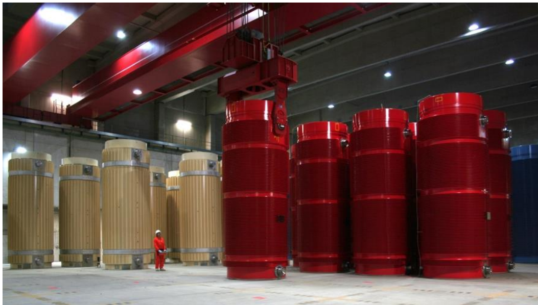
圖 3.1.1-3 德國 Gorleben 集中式貯存場金屬護箱室內貯存
