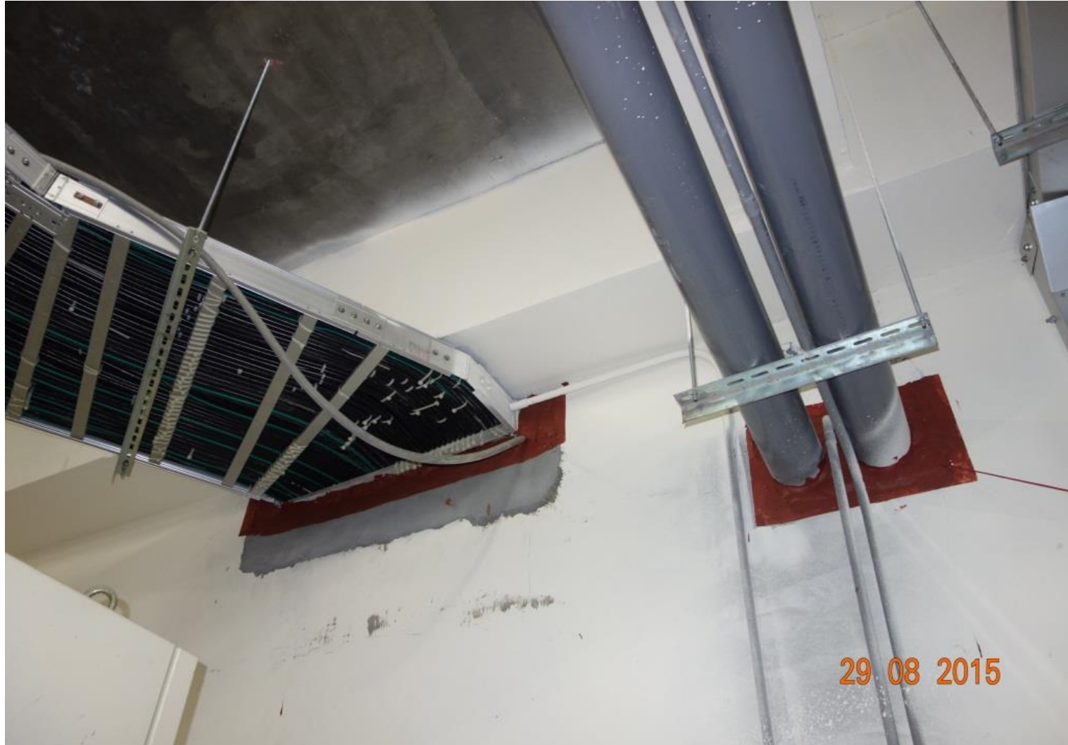
圖98工程會扣點編號5070414 說明：PVC管防火填塞施工不良
