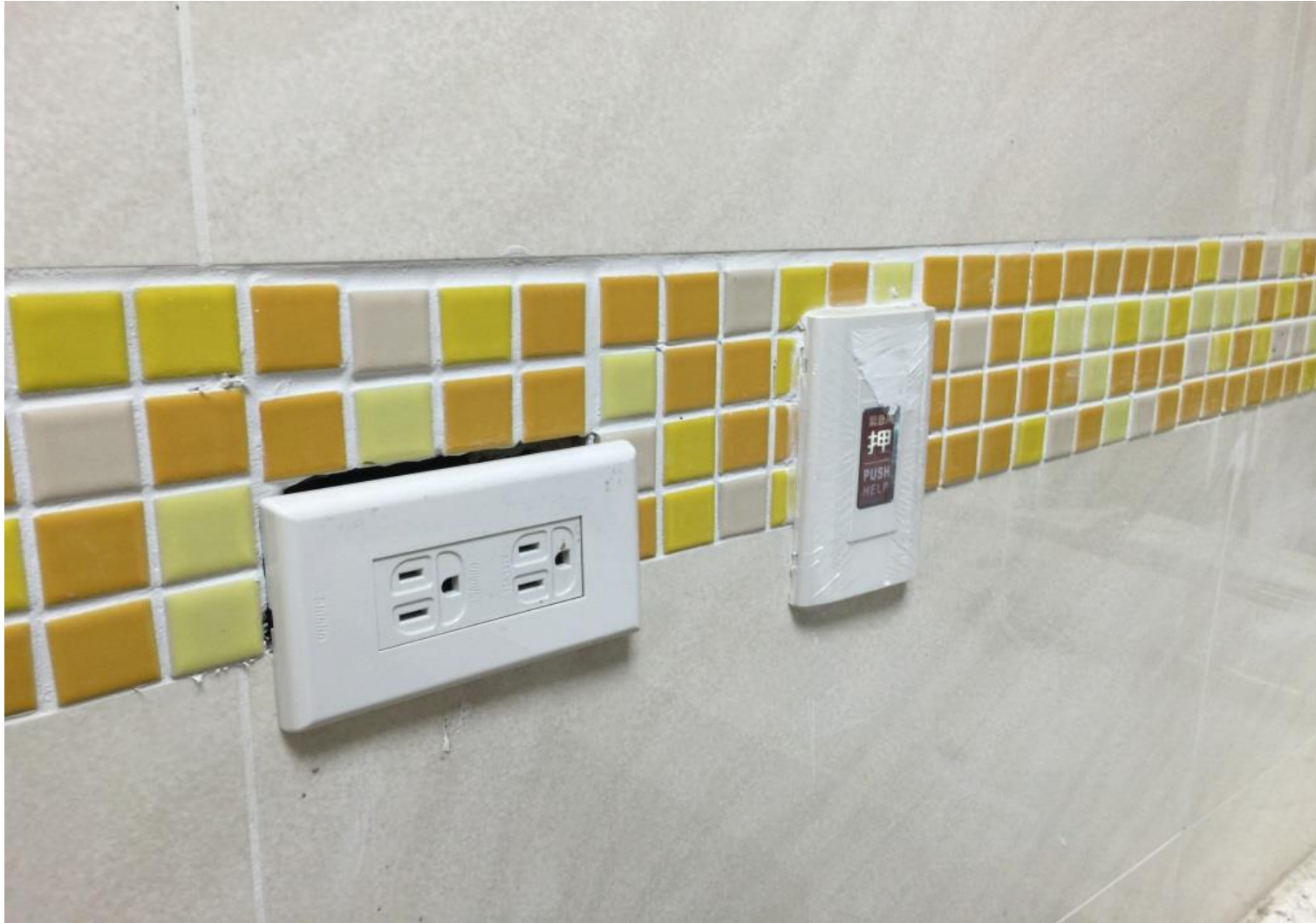
圖129工程會扣點編號5080908 說明：出線口與牆壁磁磚介面不良
