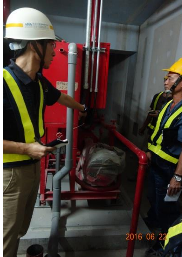
圖93工程會扣點編號5070412 說明：管路與震動設備之間未使用軟管連接
