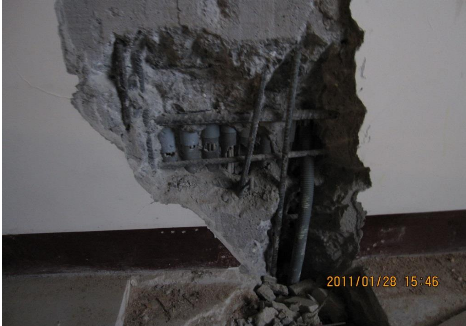
圖113工程會扣點編號5070499 說明：打鑿不良破壞管路
