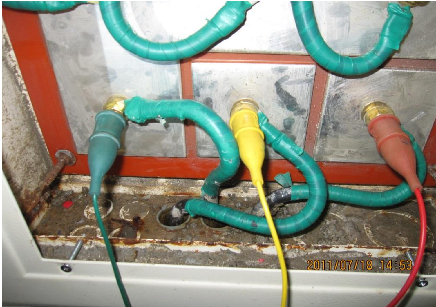
圖119工程會扣點編號5070602 說明：接地線止水措施不良，
