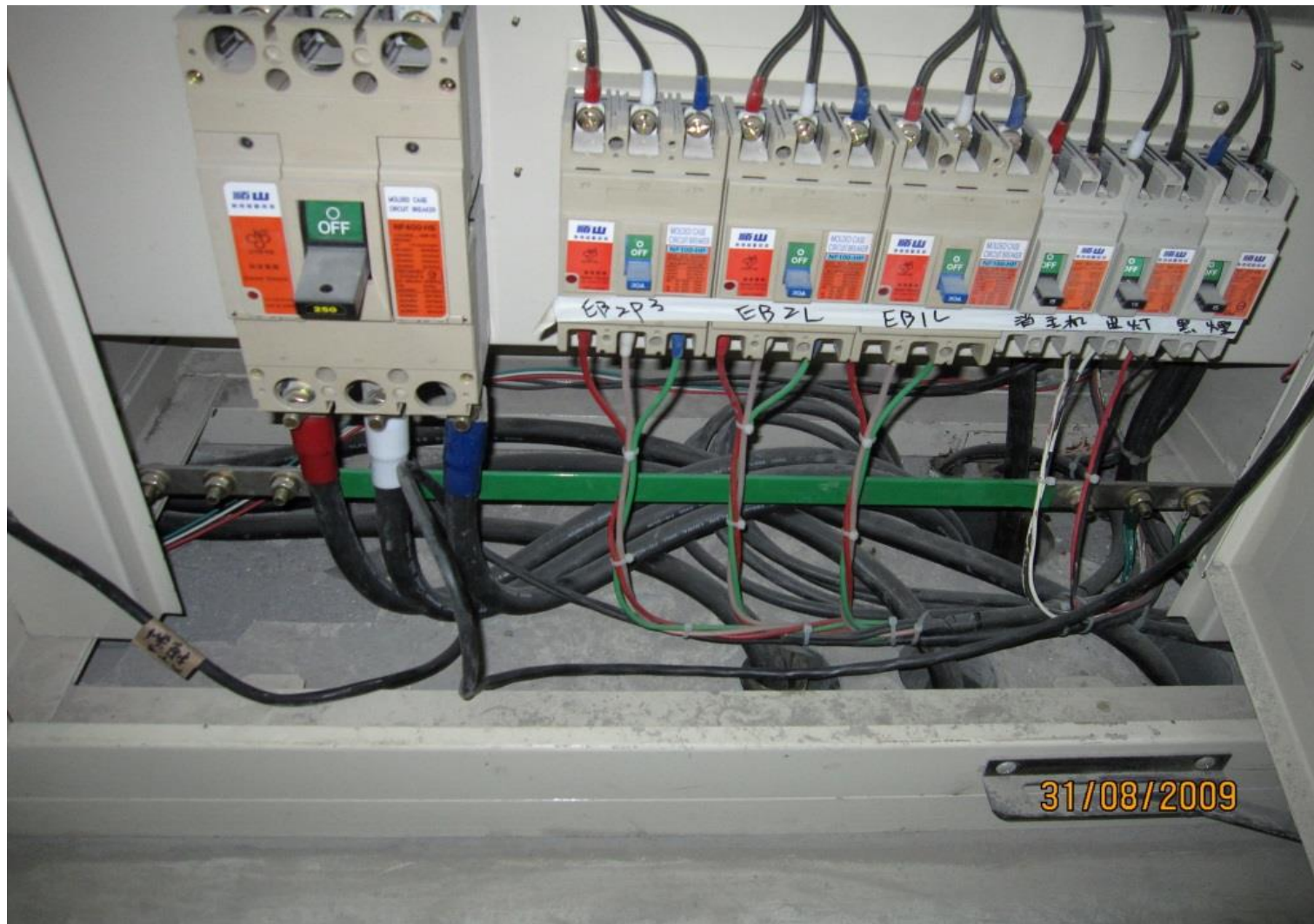
圖103工程會扣點編號5070419 說明：電纜線使用日地未標示
